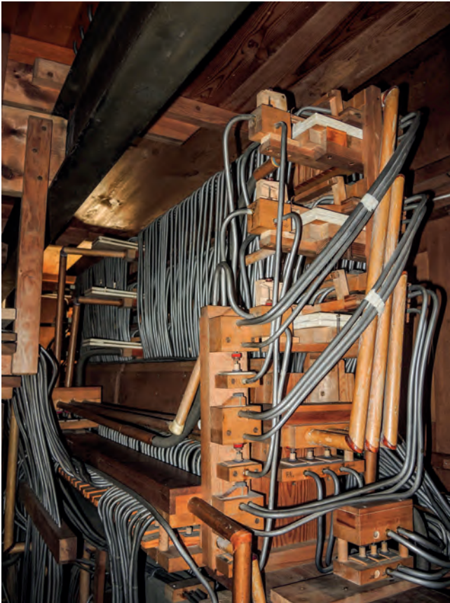
Die dreifache pneumatische Setzeranlage.
